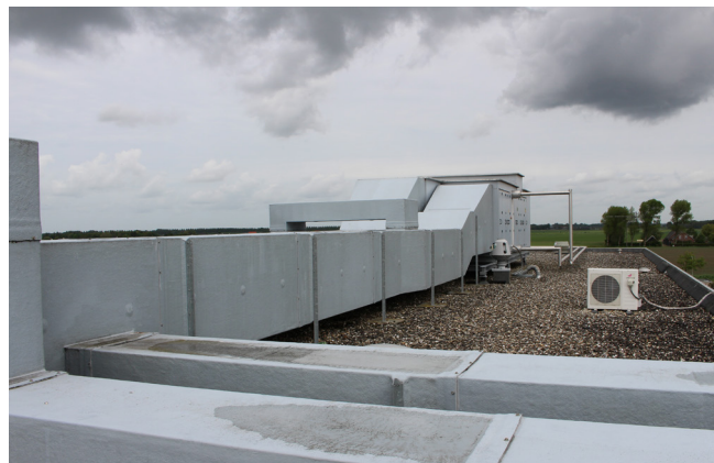
Centrale LBK op het dak
