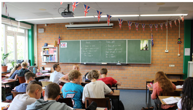
De aan- en afvoerroosters van de luchtbehandeling zijn opgenomen in het verlaagd plafond
