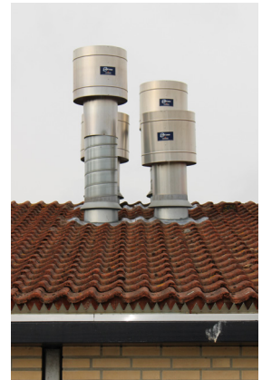
Aan- en afvoerpijpen op het dak
