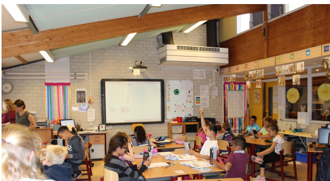
Klaslokaal met decentrale LBK aan het plafond
